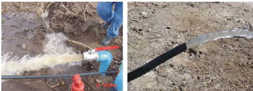
Foto 24. Lavado de la red de riego con eliminación del agua en la submatriz o terciaria (izquierda) y fin de laterales (derecha).
