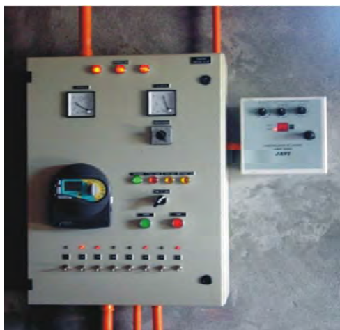
Foto 20. Tablero eléctrico con reloj control que permita automatizar la partida de la motobomba y la apertura de los sectores de riego.
